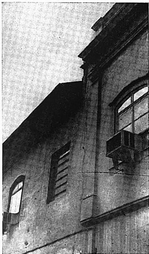
Foto 3A — Pormenor mostrando onde começa a platibanda neoclássica e termina o beiral antigo e ali interrompido
