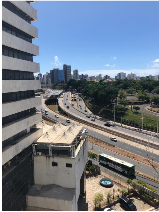
Figura 4 – Imagens comparativas entre o início, em fevereiro de 2020, e após, em outubro de 2020, a construção do viaduto para o BRT na Avenida Antônio Carlos Magalhães. Fotos: Tadeu Barradas Badaró, 2020.
